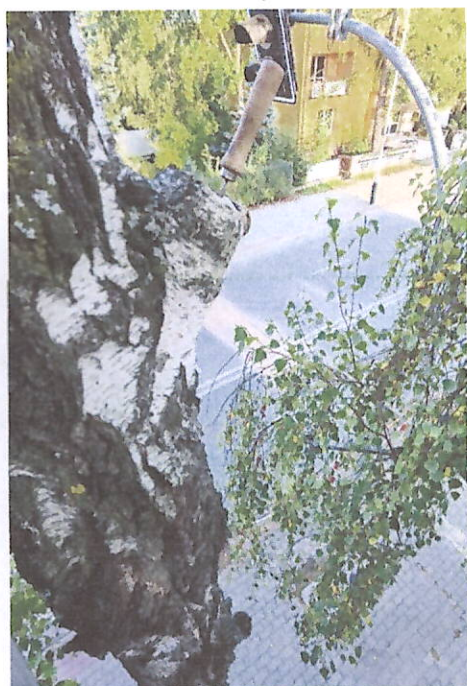
fot.13 Ubytek na przewodniku centralnym
